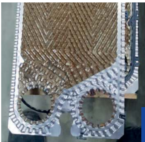
Beläge auf einer Wärmetauscherplatte durch verschmutztes Kühlwasser
